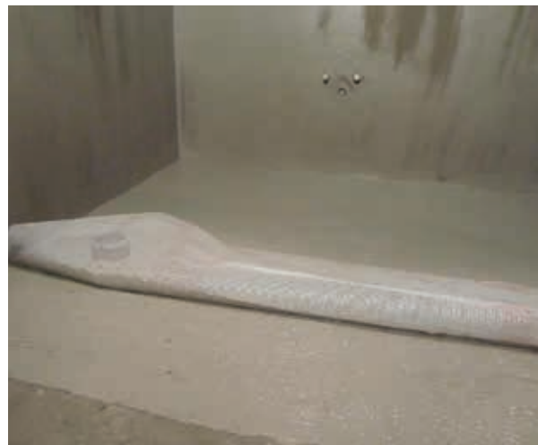
Obrázek 6: Hladítkem nanese druhou vrstvu hydroizolační hmoty a na podlahových površích do ní vtiskneme plastifikovanou alkáliím odolnou skelnou mřížku.
